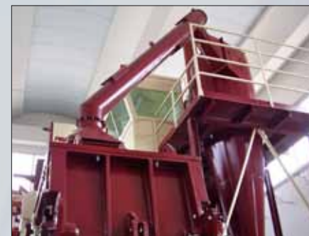
impianto di aspirazione
