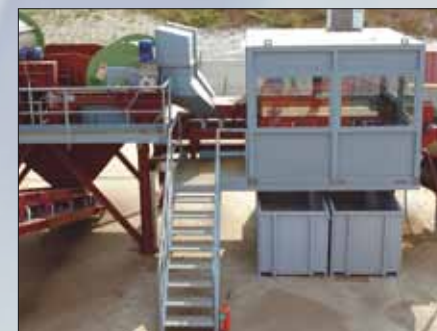
cabina di cernita
