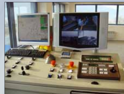
consolle di comando
