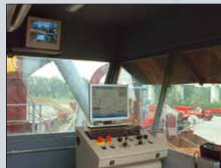
cabina di comando con sistema di gestione
