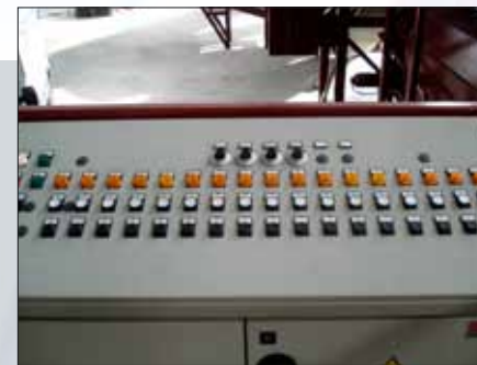
consolle di comando | control panel
