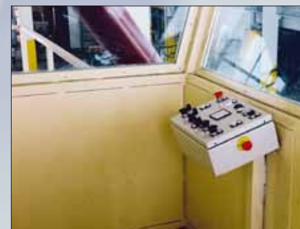
consolle di comando
