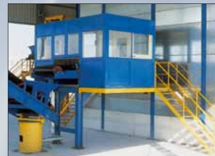
Cabina di cernita
